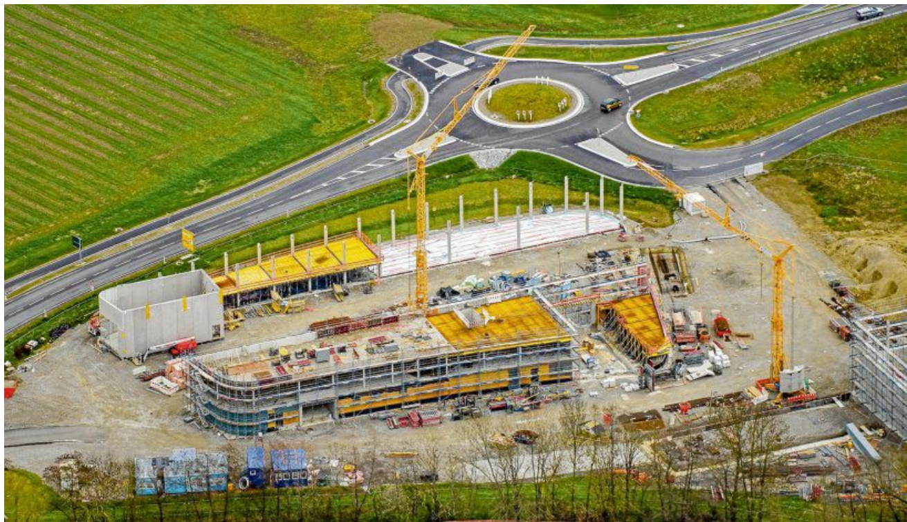
Der Bodenseekreis baut in Markdorf die neue Straßenmeisterei des Landkreises, ein 18,6-Millionen-Euro-Projekt. Die Hochbauarbeiten für die Gebäude laufen, und im Inneren sind bereits Trockenbauer tätig. FOTO: GERHARD PLESSING
